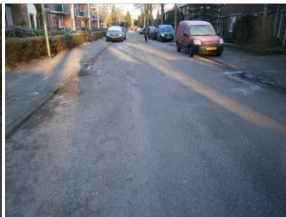
Straat Westereng (nog te renoveren). Asfaltverharding met veel veegvuil
